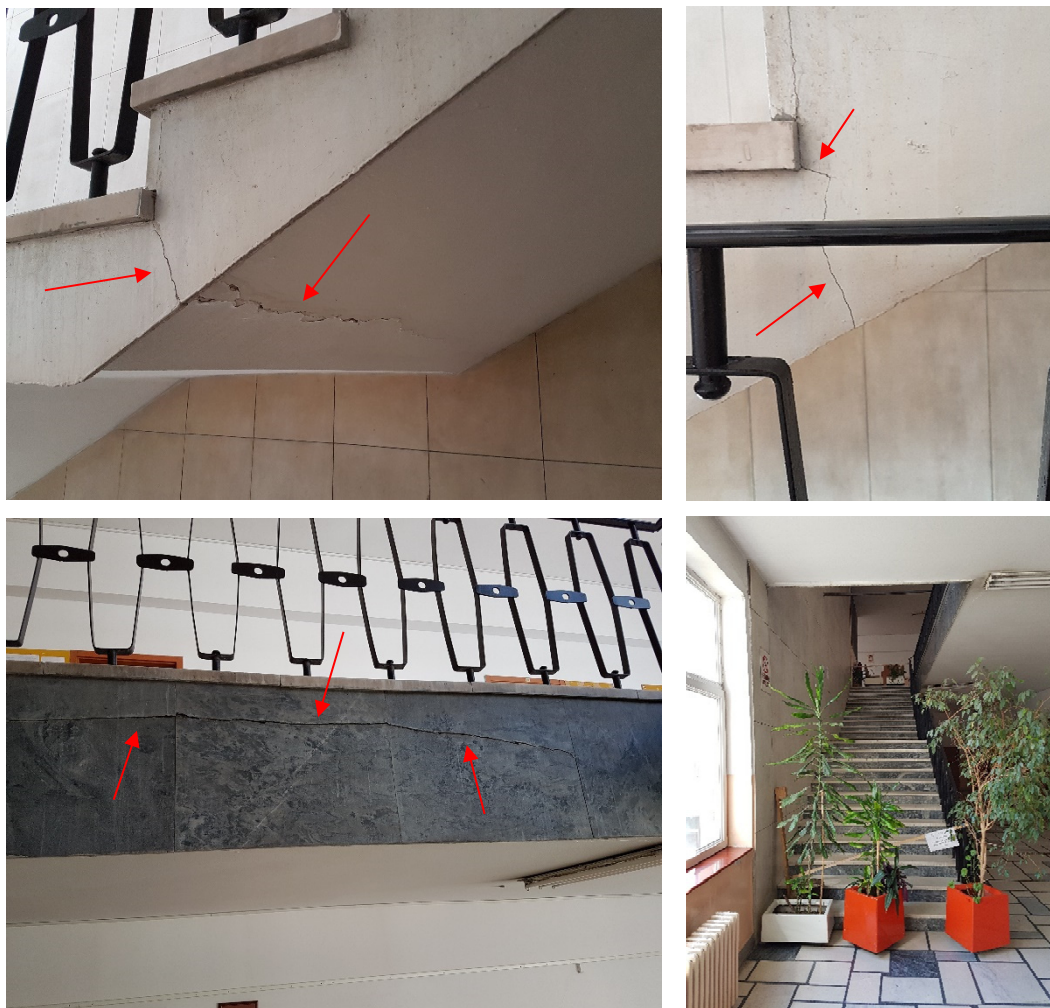
Сл. 3. Оштетувања на армирано бетонски скали од дејство на земјотрес
