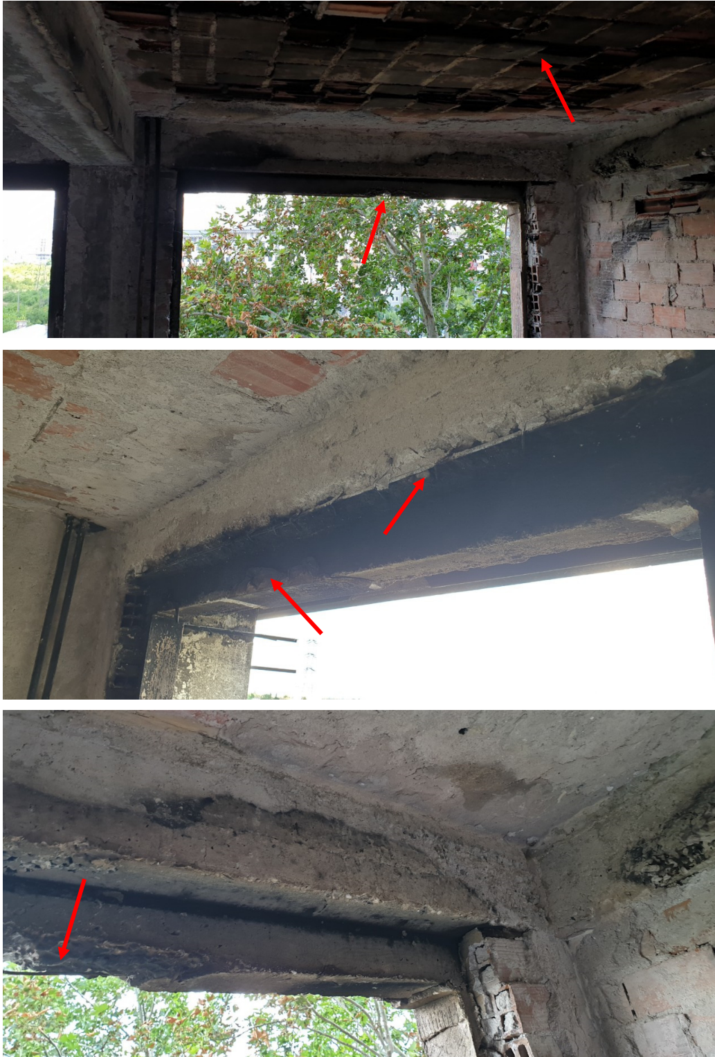
Сл. 2. Опожарени елементи (а) опожарена меѓукатна плоча (б), (в) опожарени гредни елементи
