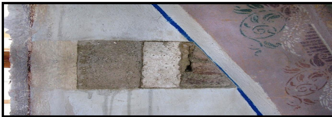
Сл. 223. Оштетување на ѕидот од водата.
