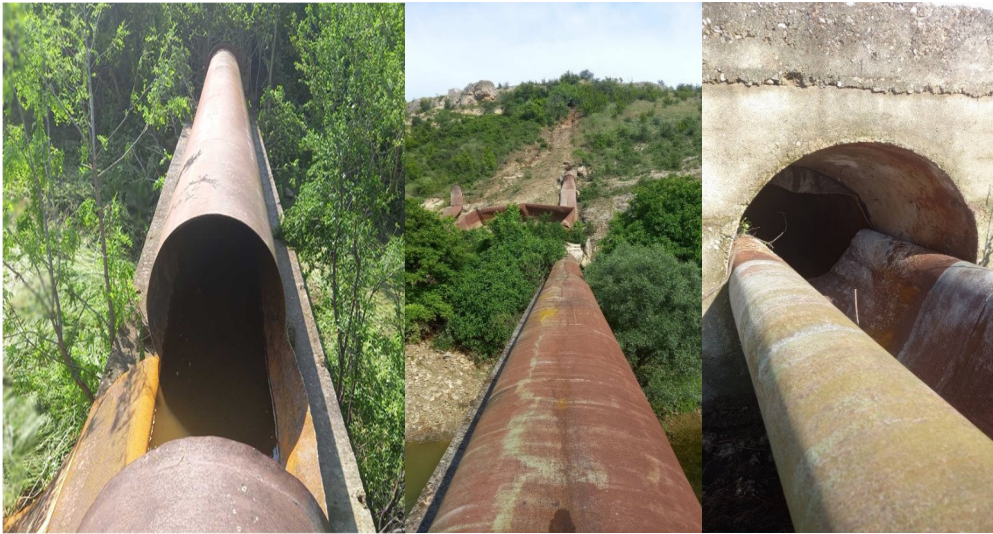
Слика 2. Состојба на цевководот после хаваријата
