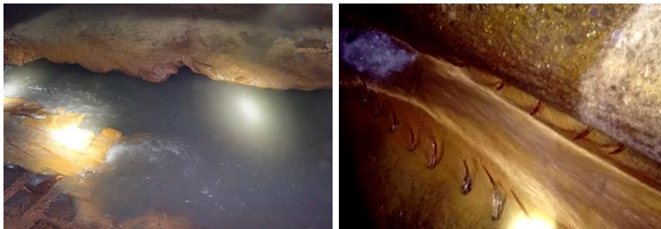
Hemiska i mehanička oštećenja betona prouzrokovana vodom koja protiče
