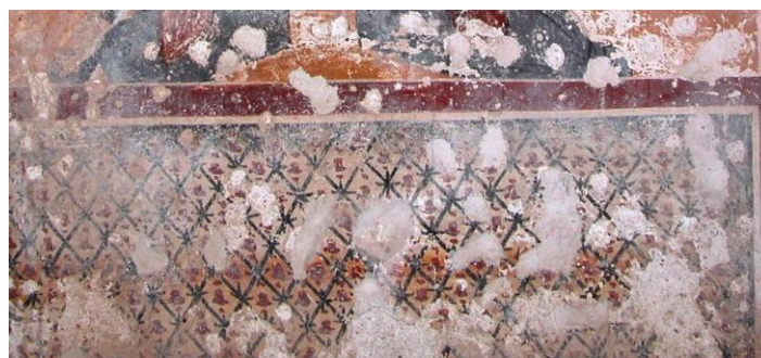
Сл. 72 Цокле во првобитниот слој живопис, западен ѕид, топлички наос
