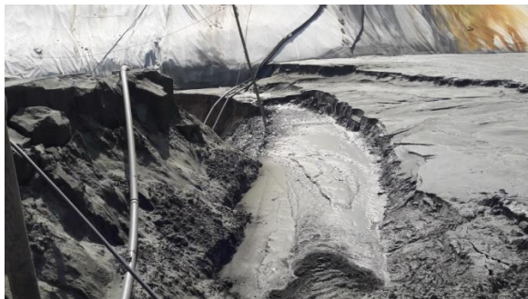
Слика 3.2. Отвор низ круната на браната каде што истекла складираната отпадна вода
