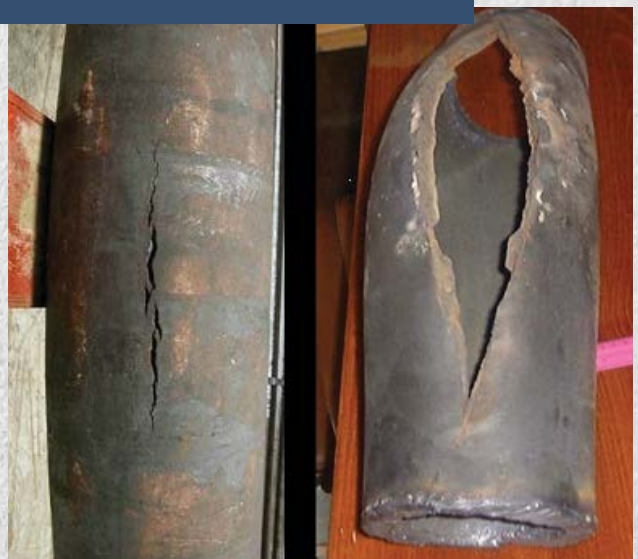
Слика 2: Дефект од ползење на цевка од термоцентра, развој од пукнатина до лом
