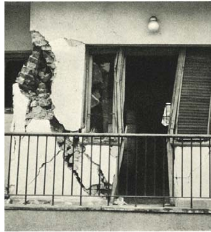
Слика 3.8: Оштетувања на објект со конструктивен систем од носиви ѕидови од тула. Извор: United Nations, 1970
