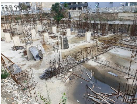
Сл. 2. Вертикални деформации на аб. плоча
