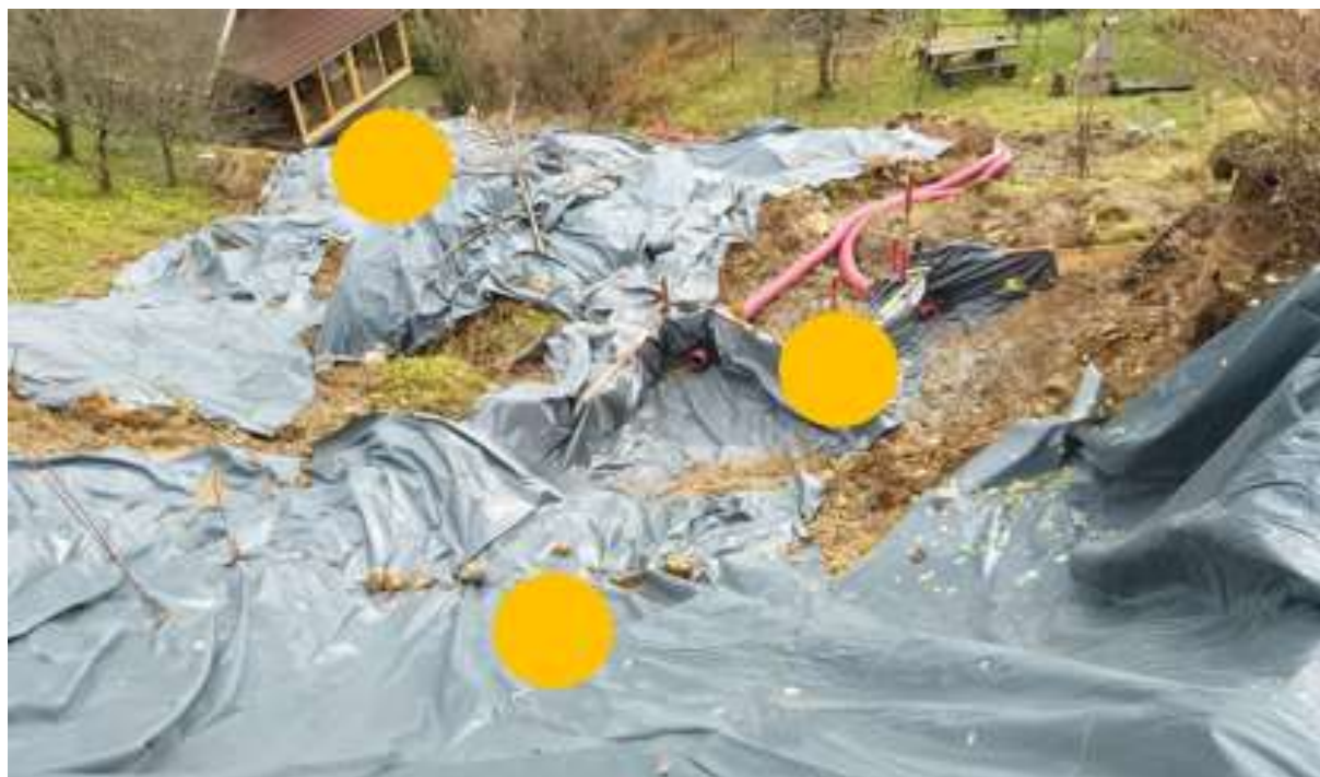
Slika 15: Detektirani pojavi izvirov (označeni z oranžno). Vidni so tudi prvi ukrepi preusmeritev dotokov površinskih voda na telo plazu, odvodnjavanje vod iz telesa plazu z drenažnimi cevmi, prekrivanje plazu s folijo za preprečevanje omočenja plazine.
