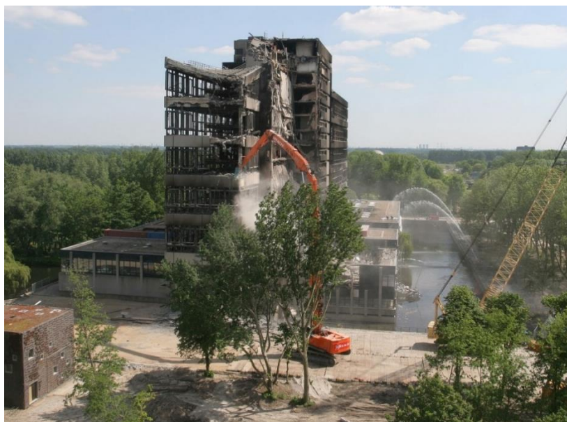
Слика 2.4. Објект “Архитектонскиот факултет во Делфт, Холандија“ после дејство на пожар
