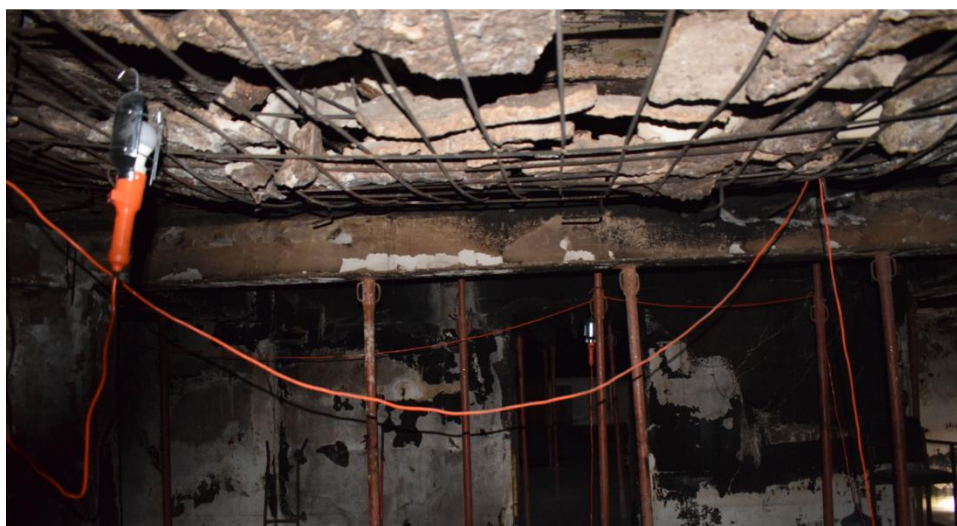
Слика 2.10. Рушење на АБ плоча во едно поле, како резултат на експлозивно прскање на бетонот и надмината носивост на плочата
