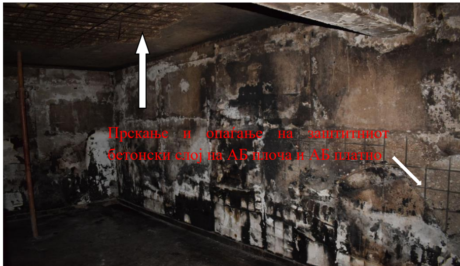
Слика 2.11. Прскање и отпаѓање на заштитниот бетонски слој на приземна плоча од долна страна и на АБ платно во подрумот
